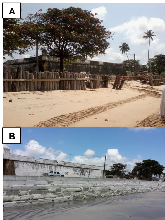
Figura 2 – A) Área degradada em frente ao forte de Pau Amarelo antes da construção do Bagwall ; B) Área recuperada após a construção do Bagwall no mesmo local.
